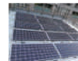
赤坂営業所発電所
