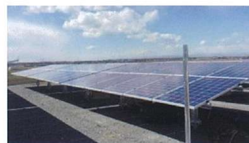
筑西市成井発電所
