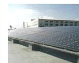
東村山本社発電所
